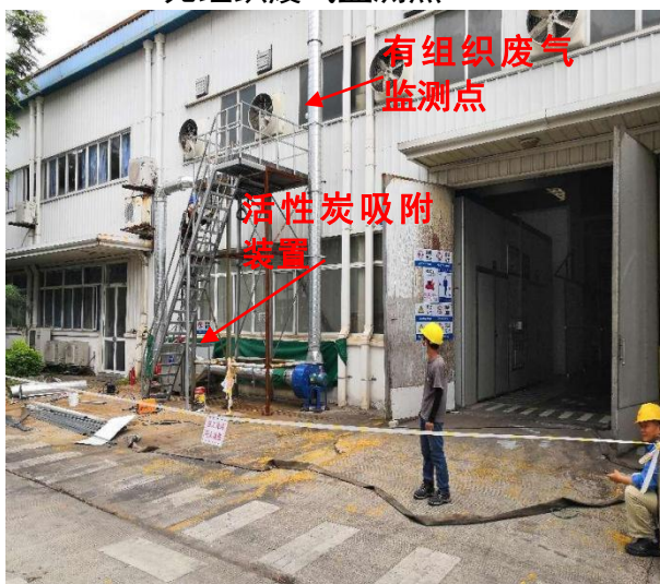
发泡废气处理设施及排放口
