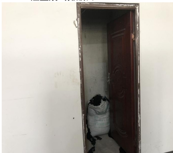
危险废物暂存间
