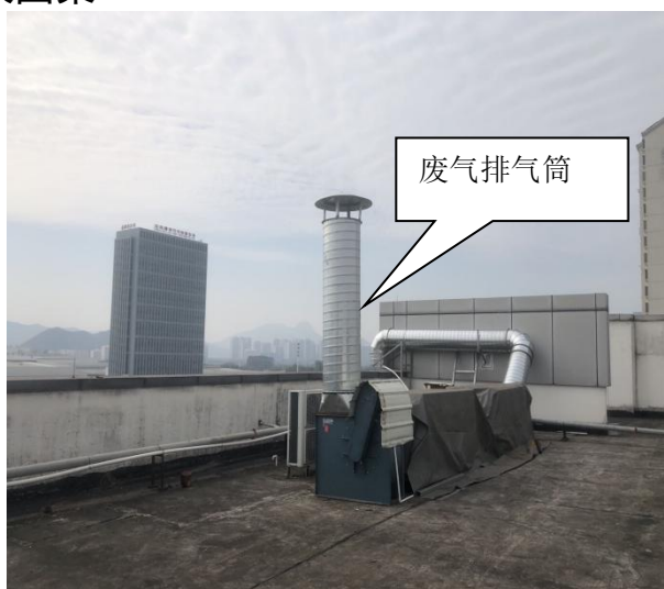
注塑废气排放口
