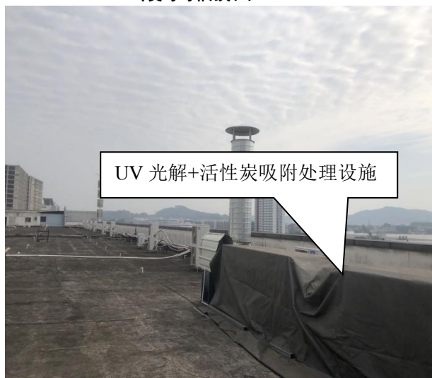
注塑废气 UV 光解+活性炭吸附处理设施
