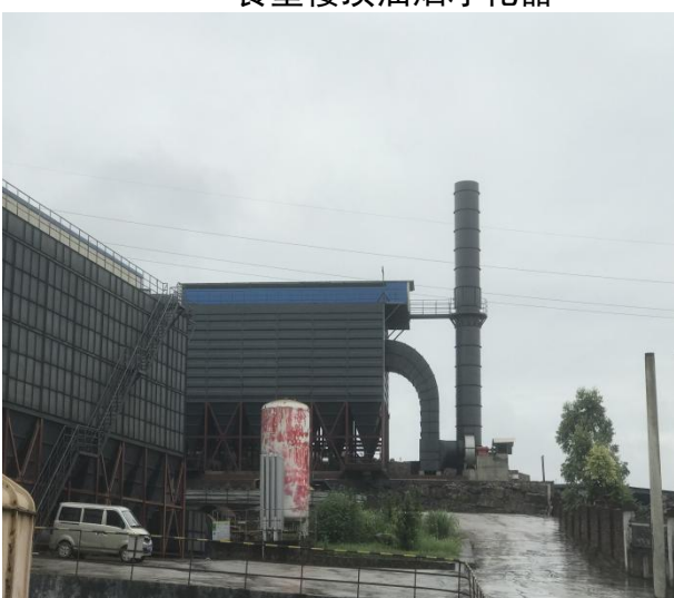
废气处理设施及排气筒
