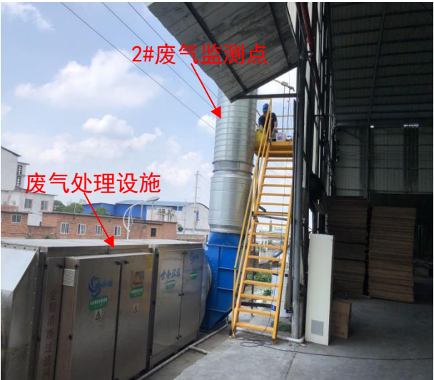
热压、涂胶工序废气处理设施及 2#废气监测点
