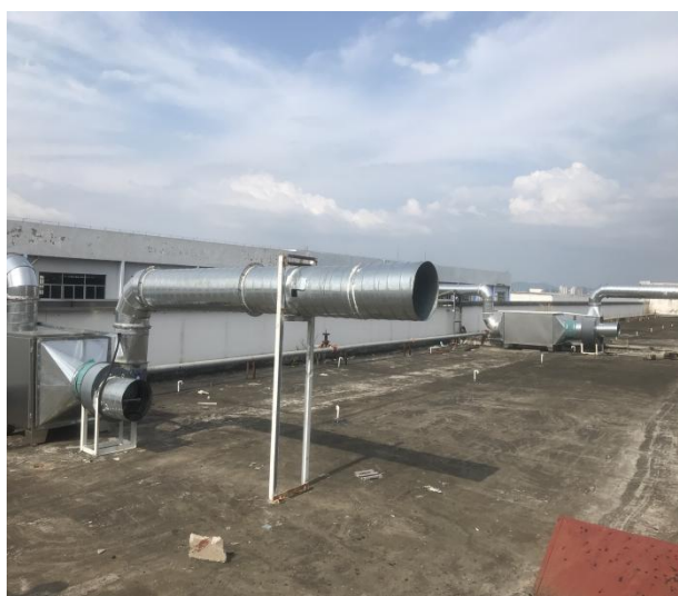
焊接废气排气筒
