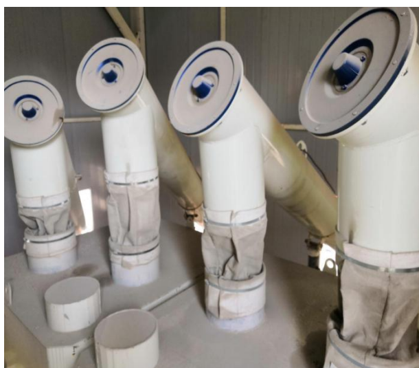
罐体处脉冲袋式除尘器
