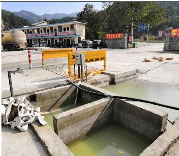
厂区大门处生产废水沉淀池
