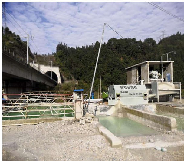
厂区内生产废水沉淀池
