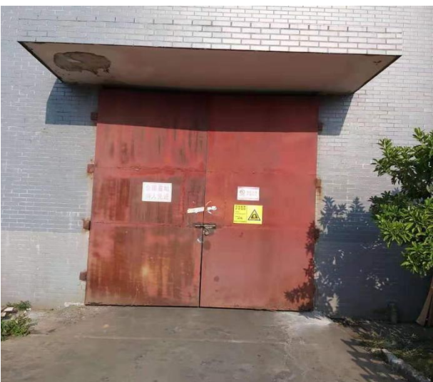
危险废物暂存间
