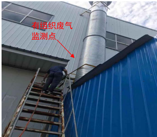
焊接烟尘排气筒
