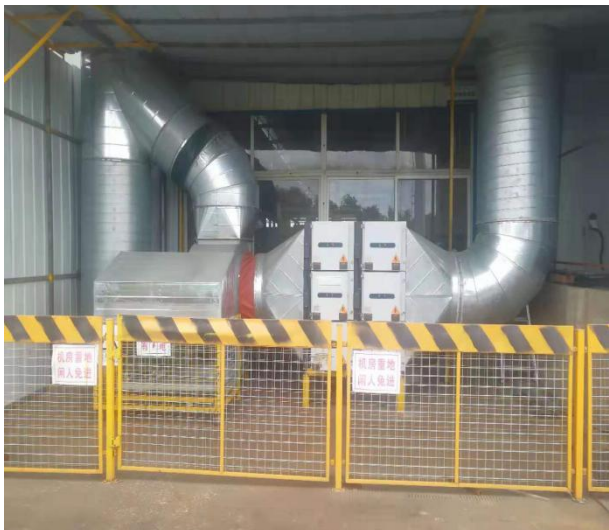
焊接烟尘静电除尘处理设施
